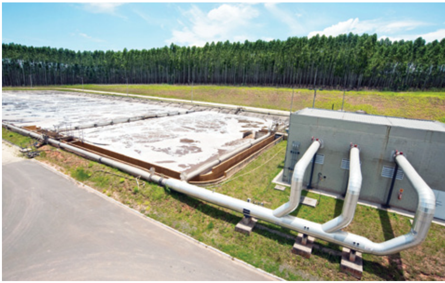
FIGURA 11. TRATAMENTO DE ÁGUA
