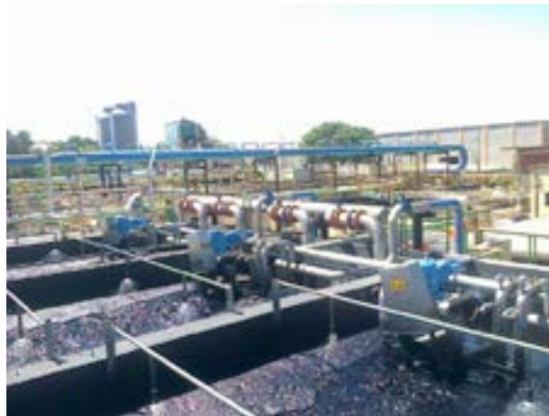
Estação de Tratamento de Efluentes – Cedro Cachoeira.
