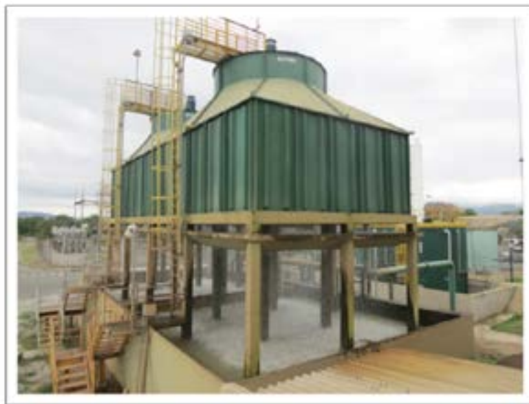
Torre de resfriamento da linha de refusão em Pindamonhangaba (SP). Crédito: Novelis
